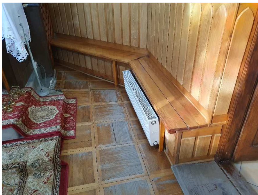
Fot. 3. Widok zapadniętego podestu prezbiterium
