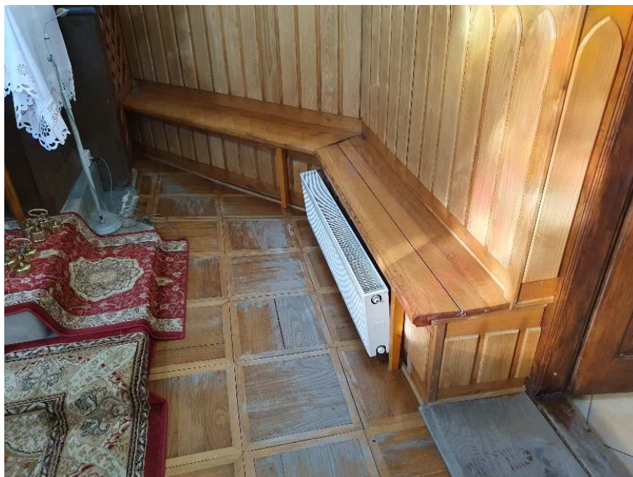
Fot. 3. Widok zapadniętego podestu prezbiterium
