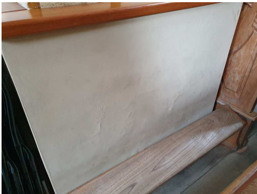
Fot. 1. Zawilgocony słup wewnątrz budynku
