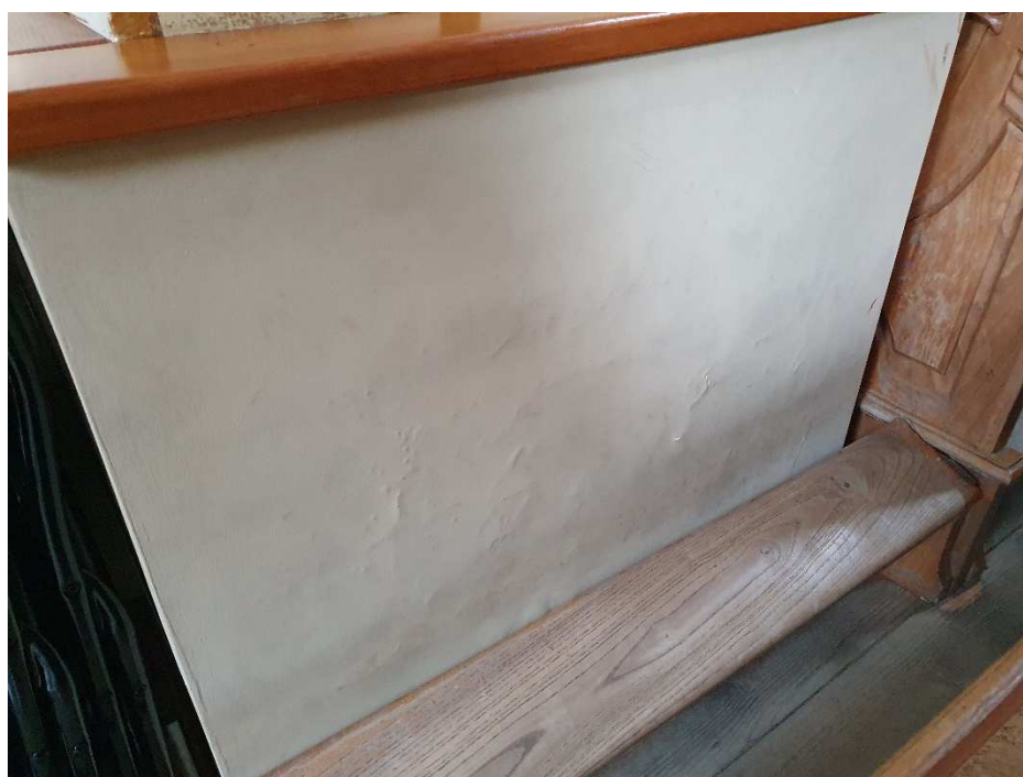
Rys. 6. Widok na zawilgocony słup wewnętrzny
