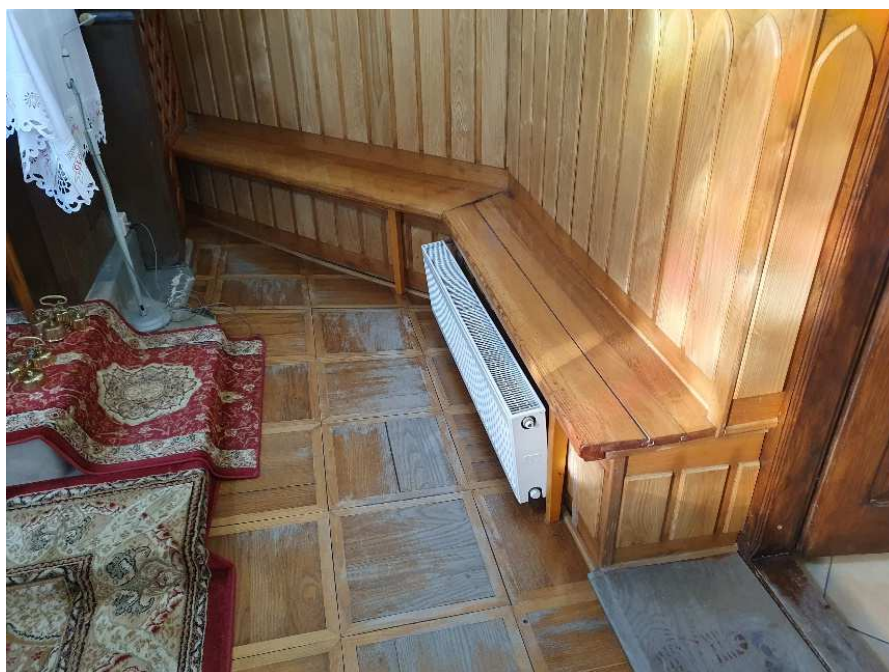
Fot. 3. Widok zapadniętego podestu prezbiterium
