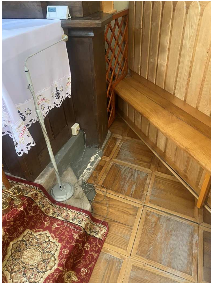
Rys. 9. Widok zapadniętego podestu prezbiterium
